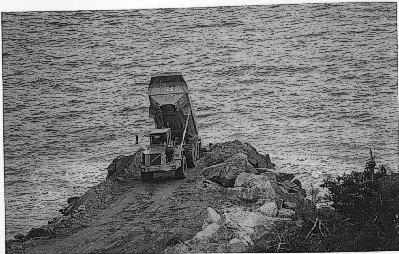
Figura 7. O vertido directo de sedimentos ó mar sen ningún tipo de contención están a producir un impacto moi negativo sobre as poboacións do fondo da ría.
